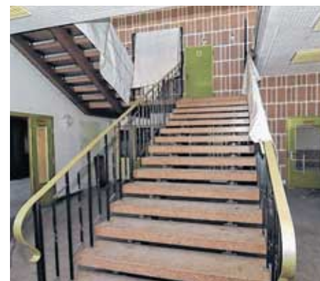
Stufen ins Obergeschoss: In den Saal gelangt man über eine große Treppe. Auch sie ist noch tadellos erhalten.
